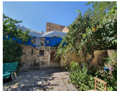
Fotoğraf 24. Güneydoğu Cephe Bozulmaları, Yazar Arşivi
