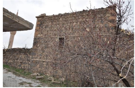
Fotoğraf 26. Kuzeybatı Cephe Bozulmalar, Yazar Arşivi
