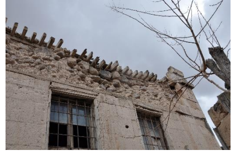
Fotoğraf 25. Güneydoğu Cephe Bozulmalar, Yazar Arşivi
