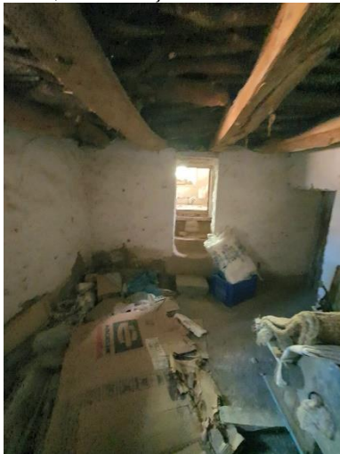
Fotoğraf 12-13. Z04 No'lu Odadan Z02 No'lu Odaya Geçişi Sağlayan Kapı, Yazar Arşivi
