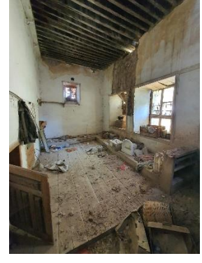
Fotoğraf 9. Z02 No'lu Odadan İç Mekan, Çatıdan Gelen Su, Duvarda Dökülmeler, Yazar Arşivi
