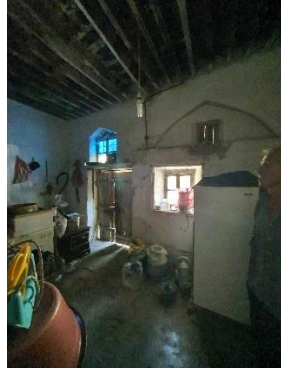
Fotoğraf 7. Z01 No'lu Odadan İç Mekan- Duvar Örülerek Kapatılan Kemer İzleri, Yazar Arşivi
