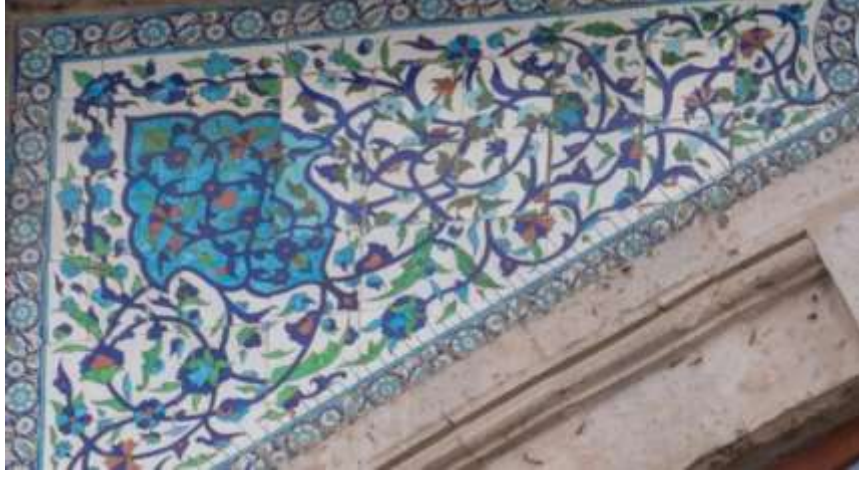
Fotoğraf 13: Adliye ve Jandarma Binası yanlış yerleştirilmiş çini (Düzgün,2024).
