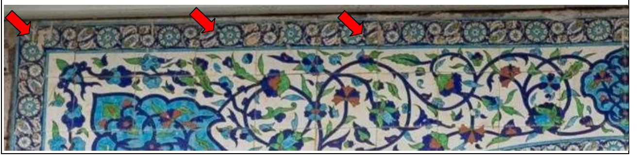
Fotoğraf 11: Vali Konağı derin ve yüzeyden çini sır kopmaları, çatlaklar (Düzgün,2024).
